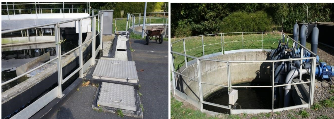
Canal de comptage en sortie du clarificateur et bache d'eau traitée
